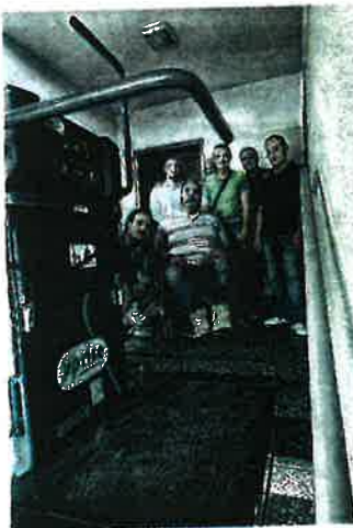
Il nuovo montascale installato
